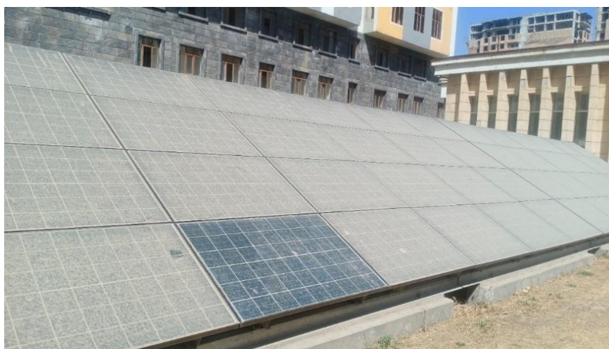
Рис. 3. Осажденная пыль на поверхности фотоэлектрических панелей Солнечной фотоэлектрической станции мощностью 40 кВт Научно-исследовательского института акушерства, гинекологии и перинатологии Таджикистана.
