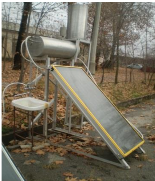
Рис.2. Общий вид солнечного водонагревателя, установленного на гелио-полигоне АН РТ.
