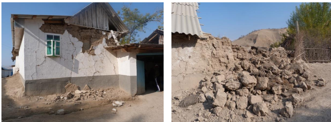
Рис. 2. Характерные повреждения глинобитных жилых домов.
